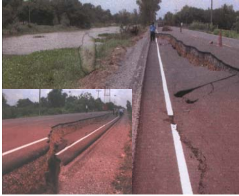
สภาพความเสียหายของคันถนนริมคลอง , ปทุมธานี
