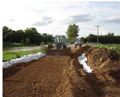
แก้ไขโดยการเสริมจุดดินส่วนเสียหายออก แล้วเสริมที่ฐานคันดินด้วยแผ่นใยสังเคราะห์ชนิดรับแรงดึงสูง, ชั้น โพลีเอทิลีน Rock PEC 150
